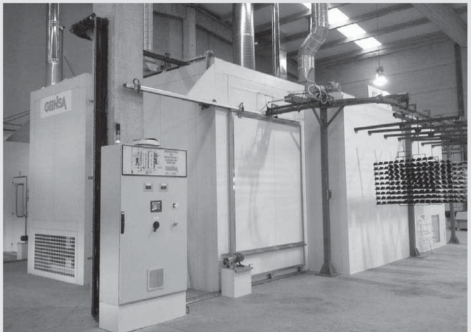
Salida del horno de polimerizado y armario de control.
