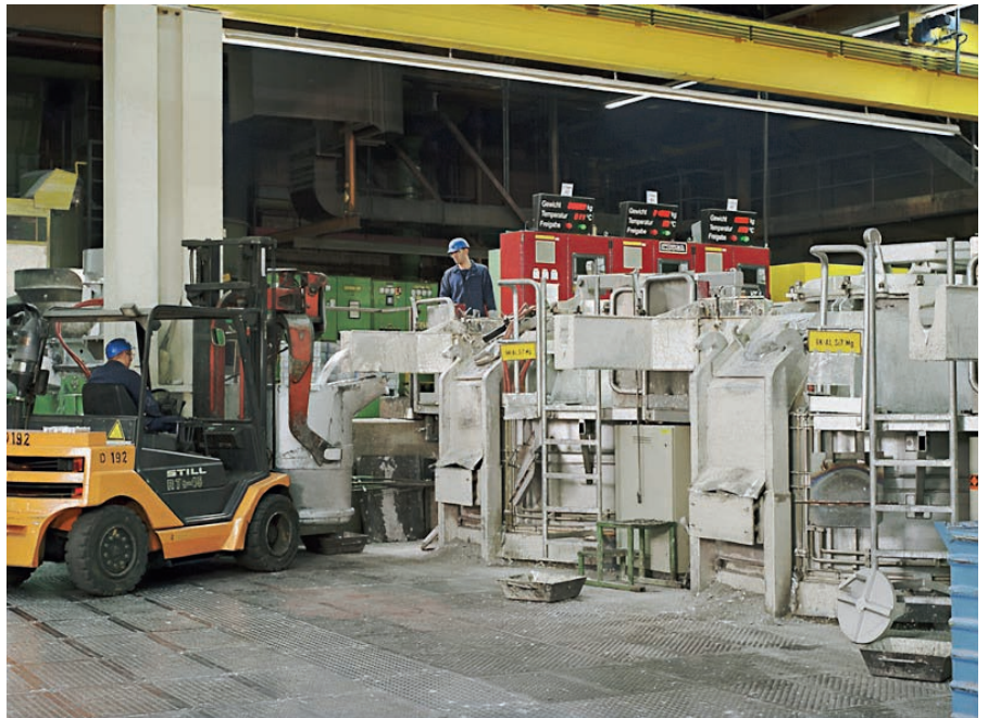
Figura 5: Hornos de almacenamiento
